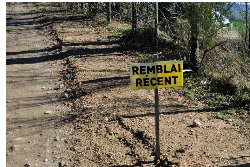
Photographie 56 : Exemple de remblai des tranchées électriques le long d'une piste (Source : ENCIS Environnement)
