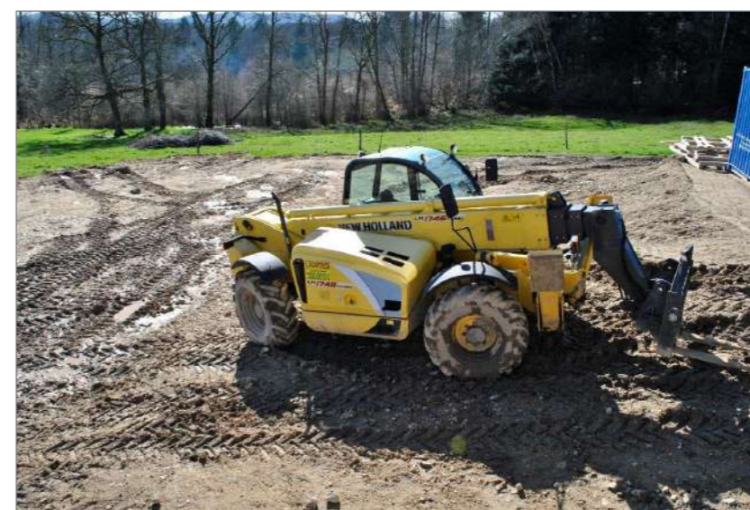
Photographie 55 : Exemple de tassement et d'ornières créés par les engins de chantier
